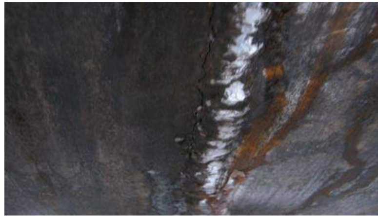
Рис. 4. Раскрывшаяся трещина на сварном соединении газопровода
